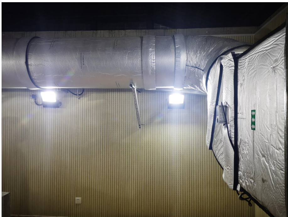
受流与磨损实验室采用吸声墙体和用隔声材料包裹管道
