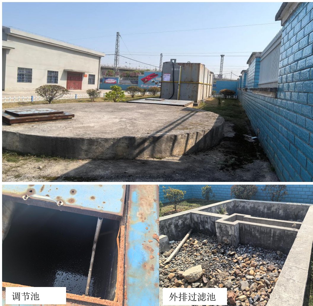
图 2.3-9 新余西站污水处理站
